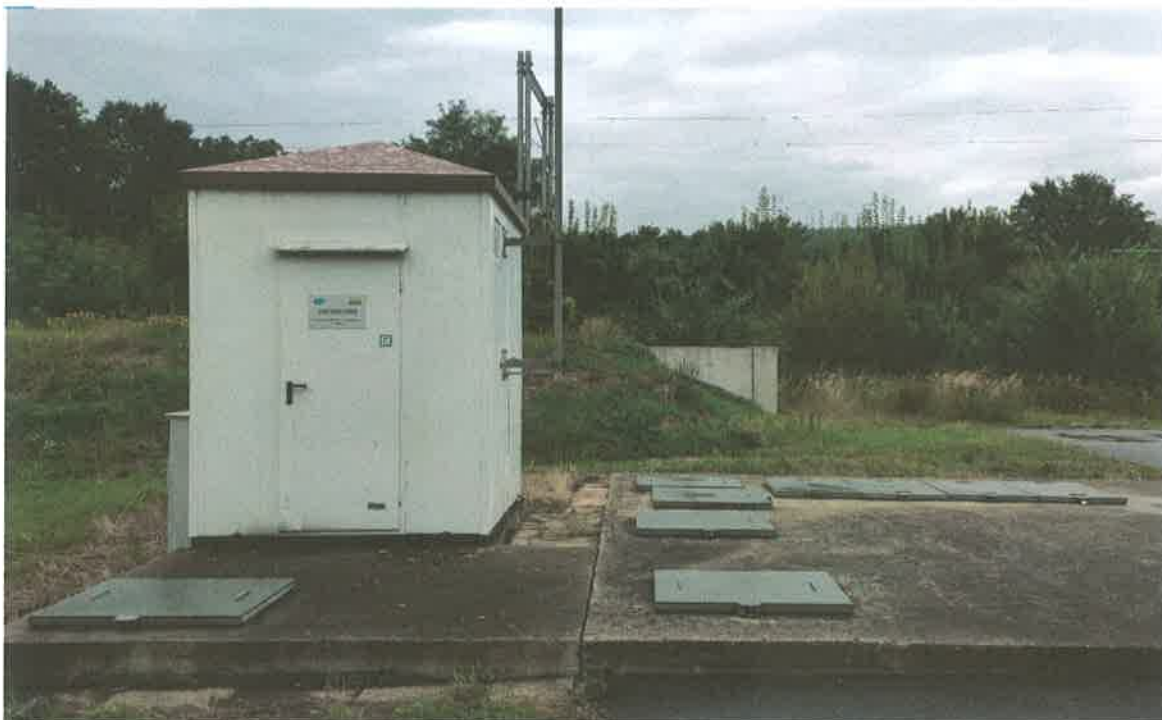
Čerpací stanice odpadních vod na pozemku p.č. 2395/31 v k.ú. Děčín
