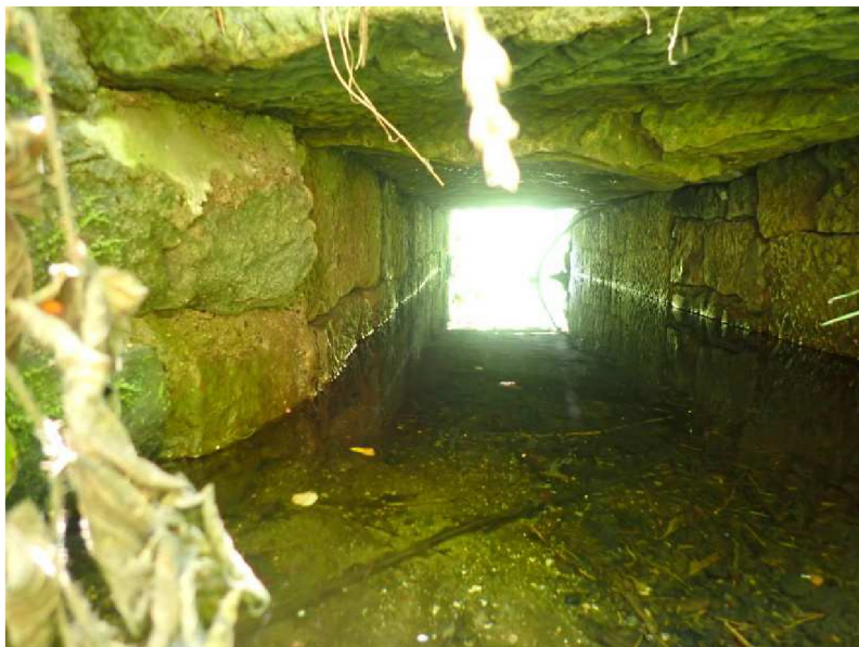
Pohled NK a pohled na obě opěry od vtoku – chybí spárování
