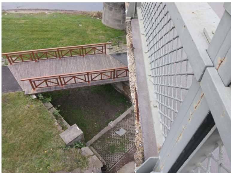
Očištěná hrana chodníkové konzoly od odpadávající sanační vrstvy na vtokové straně pravobřežního pole na vtoku.
