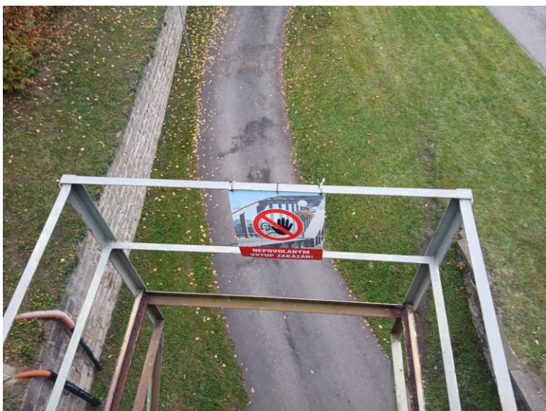
Cedule se zákazem vstupu na revizní lávku u pravobřežního opěry na vtoku.
