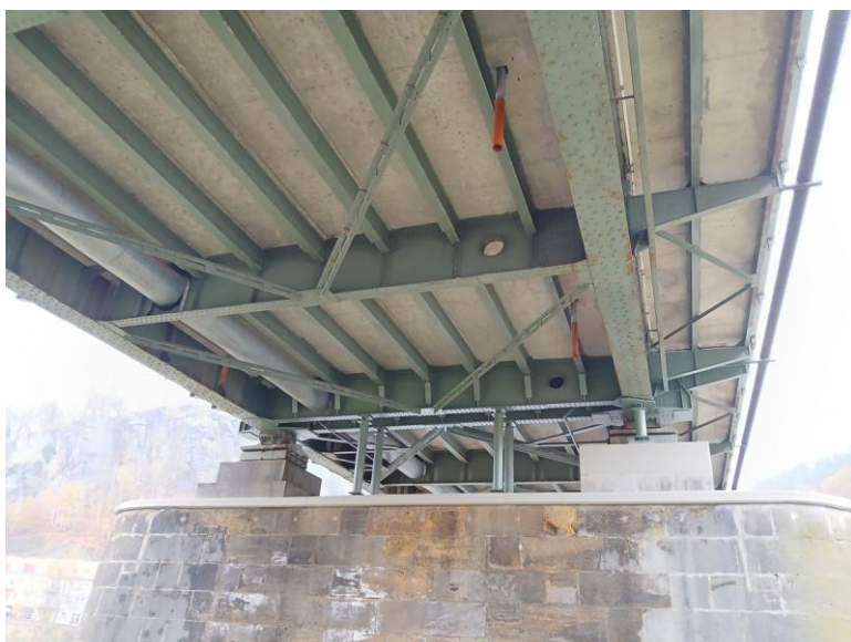
Nová žb deska pravobřežního pilíře a nové podpěrné stojky příčníků. Koroze hlavních nosníků v pravobřežním poli.
