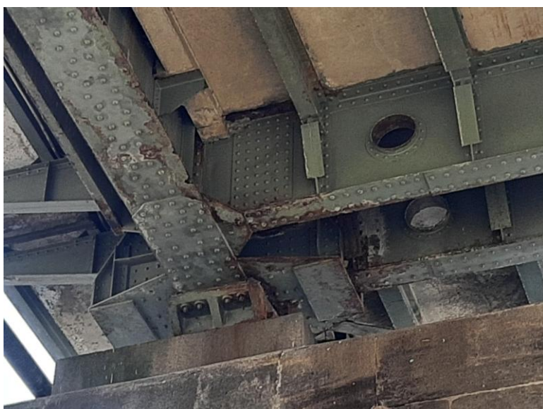
Detail koroze NK nad levobřežním pilířem.
