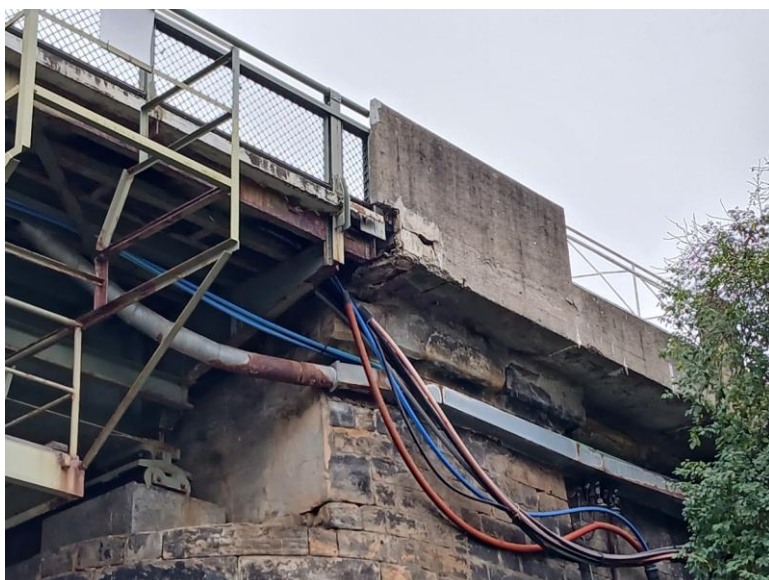
Pravobřežní opěra, vtoková strana. Uchycení chrániček nevhodně provedené a degradující betonová část zábradlí na styku s OK. Koroze OK mostu a chrániček IS.
