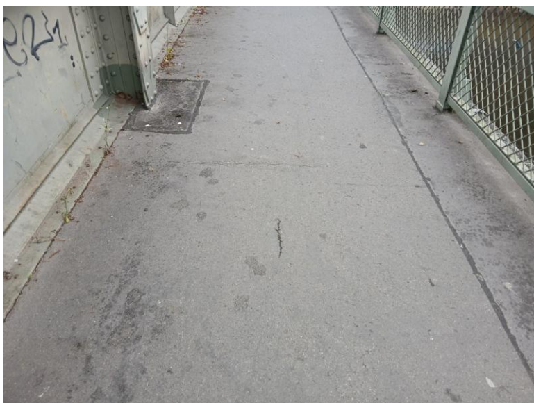
Podélné trhliny v LA na výkové chodníkové konzole.
