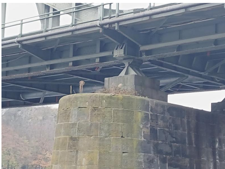
Usazená vegetace na levobřežním pilíři a výtokové ložisko.
