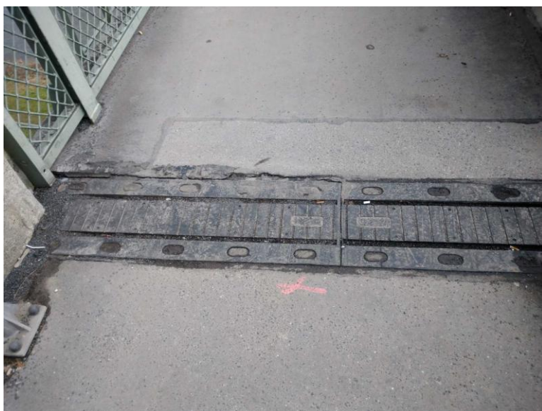
Dilatace ve chodníku nad levobřežní opěrou, výtoková strana. Patrná separace a tedy netěsnost.
