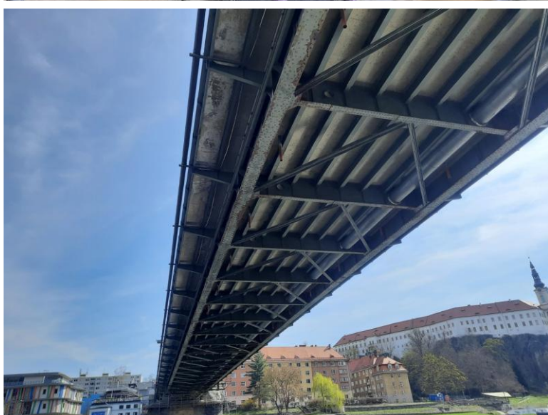
Podhled NK středního pole s korozi hl.nosníků..
