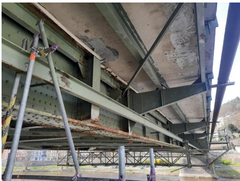
Podhled chodníkové konzoly ve středním poli se stopami po zatékání a korozi hlavního nosníku.
