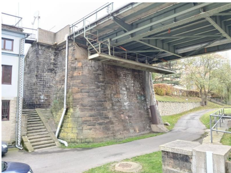
Podhled pravobřežního pole, výtoková strana s revizní lávkou, opěrou a korozi hlavního nosníku a nosníků lávky.
