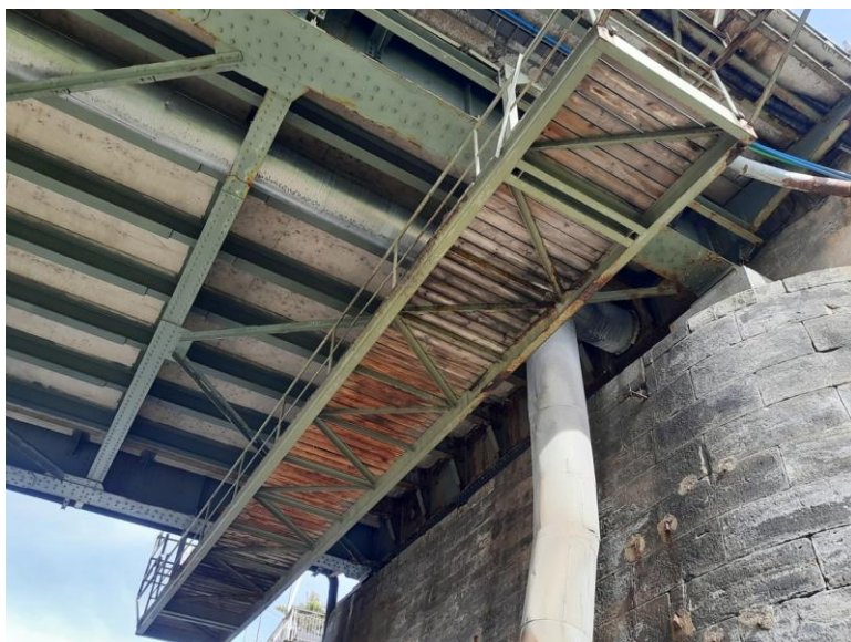
Podhled pravobřežního pole, vtoková strana s revizní lávkou a korozi hlavního nosníku a nosníků lávky.
