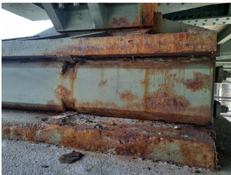
Koroze ložiska na pravobřežním pilíři.
