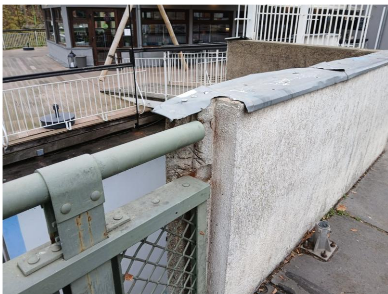
Poškozené oplechování a degradace betonu s obnaženou výztuží na styku s OK na betonovém zábradlí pravoběžným na výtoku.
