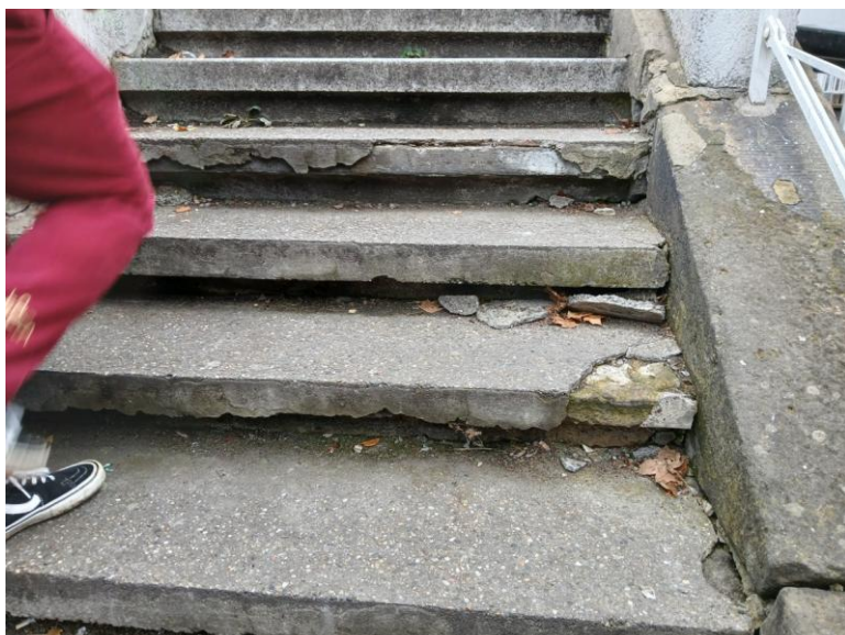
Degradované stupnice na přístupovém schodišti pravobřežním na výtoku.
