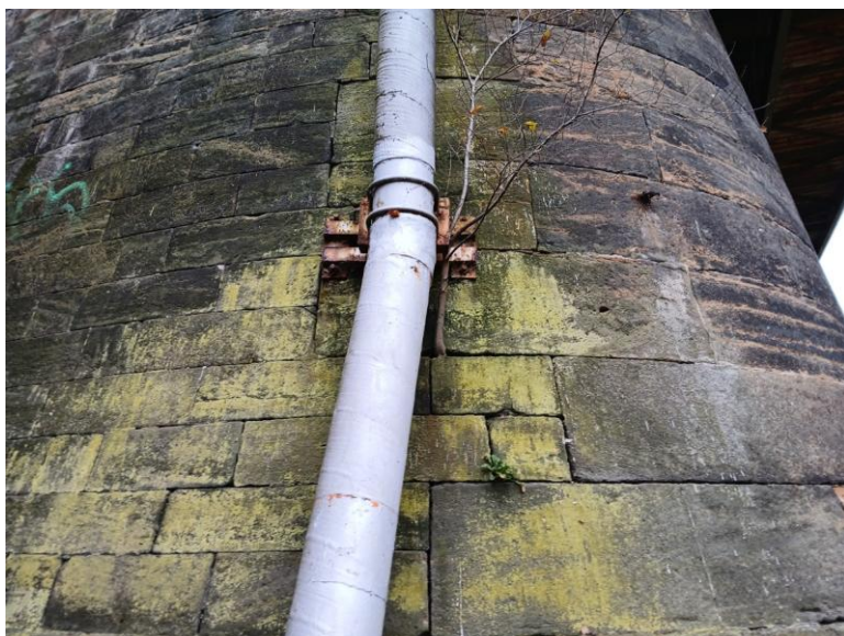
Uchycená vegetace na pravobřežní opěře na výtoku a zkorodovaný kotevní prvek plynovodu.
