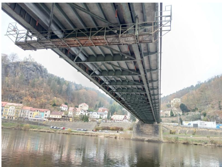
Podhled NK středního pole s korozi hl.nosníků..
