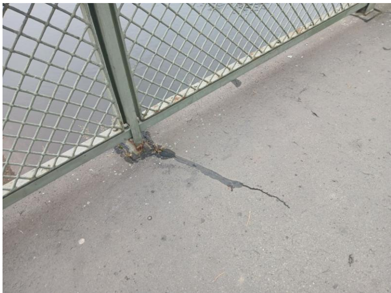
Pokračování šíření trhlin v litém asfaltu chodníků (výtoková strana), typická porucha.
