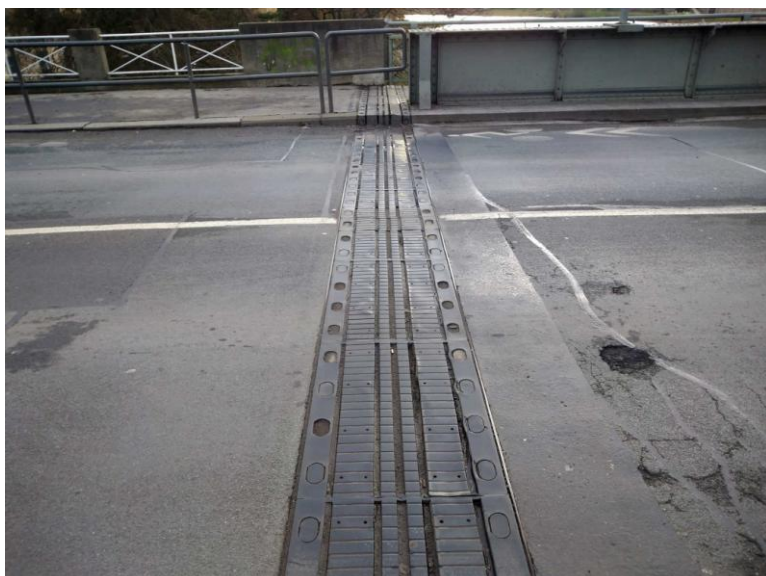
Dilatace ve vozovce nad pravobřežní opěrou. Absence krytek kotevních šroubů, výtluky ve vozovce.
