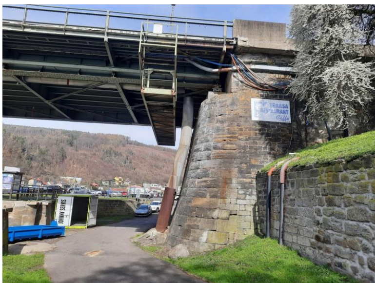
Pravobřežní opěra, vtoková strana. Uchycení chrániček nevhodně provedené a degradující betonová část zábradlí na styku s OK.
