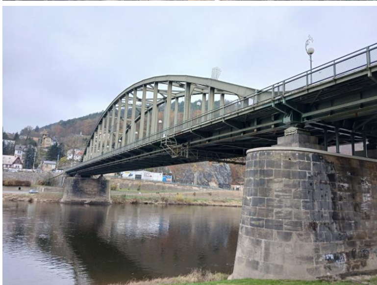
Pravobřežní pilíř s opravenou krycí žb deskou na vrchu pilíře z vtokové strany s novými podpěrnými stojkami příčniců.
