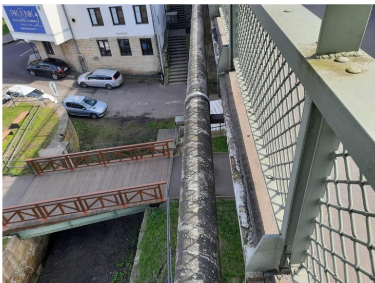
Vedení IS na výtokové straně a degradovaná krajní část chodníkové konzoly.
