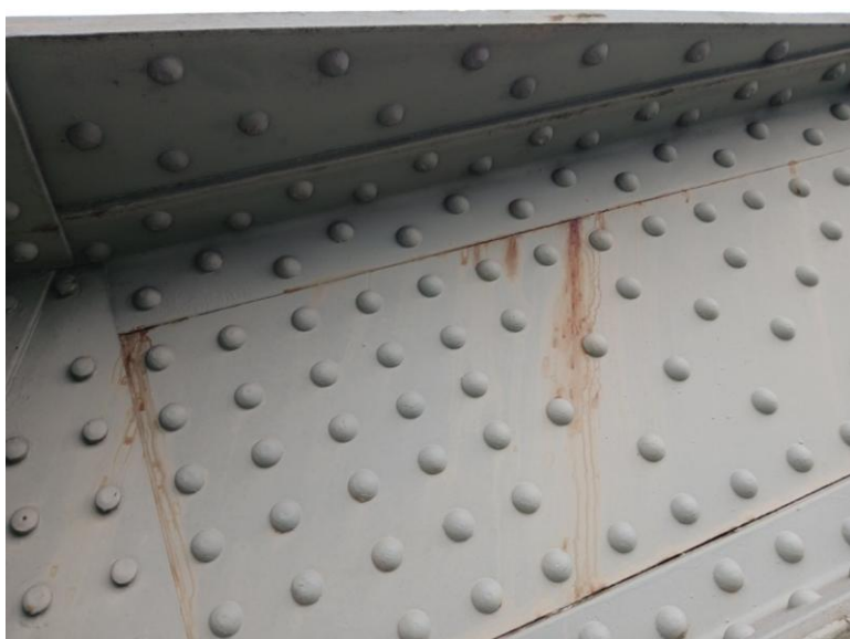
Výluhy rzi ze styku plechů hlavního oblouku na výtoku nad pravobřežní opěrou.
