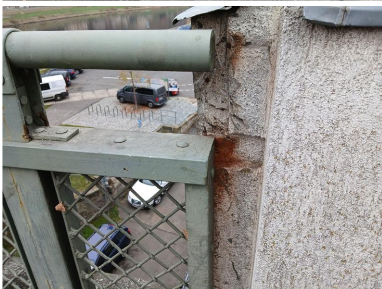
Odření žb zídky od zábradlí vpravo na výtoku vlivem dilatace.
