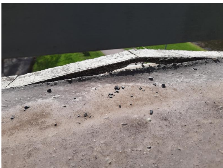
Odpadávající sanační vrstva chodníkové konzoly na vtokové straně pravobřežního pole na vtoku.
