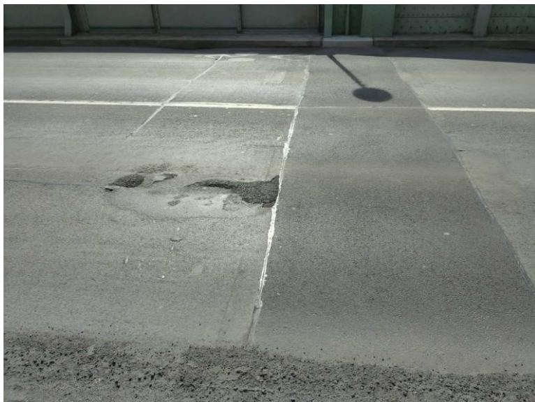
Podpovrchový mostní závěr nad pravobřežním pilířem s výtlikem ve vozovce.
