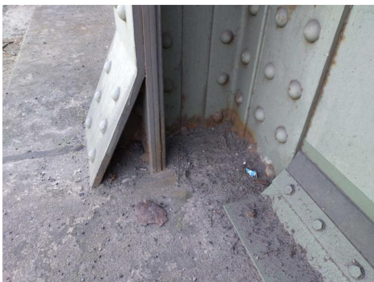
Znovu se objevující koroze v opravovaných místech paty závěsů. Typická závada v nevětraných místech, špatně přístupných pro přípravu podkladu nátěrů.
