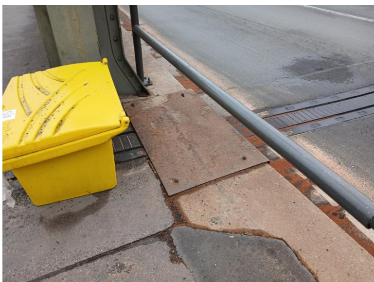
Zrezivělý krycí plech mostního závěru nad levobřežní opěrou netěsnící.
