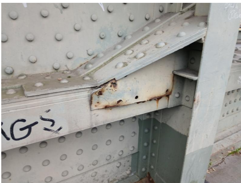
Prorezivělý krycí plech na styku hlavního oblouku a nosníku nad pravobřežním pilířem na výtoku.
