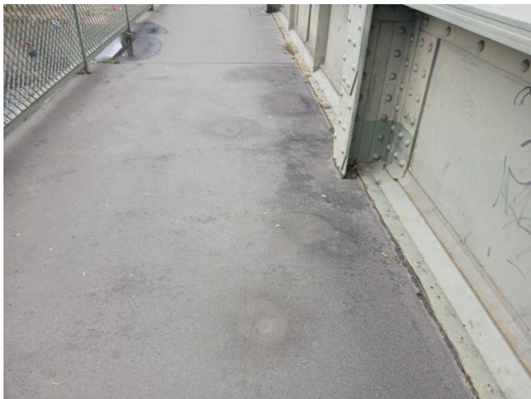
Boule v litém asfaltu na chodníku na vtokové straně pravděpodobně od nahromadění vodních par pod vrstvou LA.
