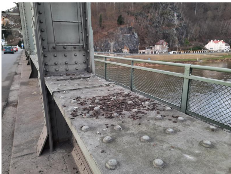
Typické znečištění horní pásnice parapetního nosníku agresivním trusem.
