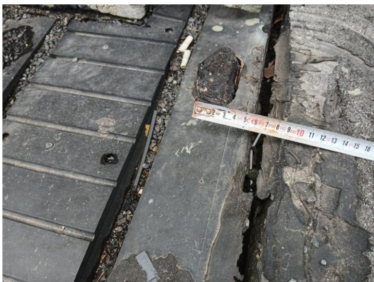
Dilatace v chodníku nad levobřežní opěrou, výtoková strana. Patrná separace a tedy netěsnost.
