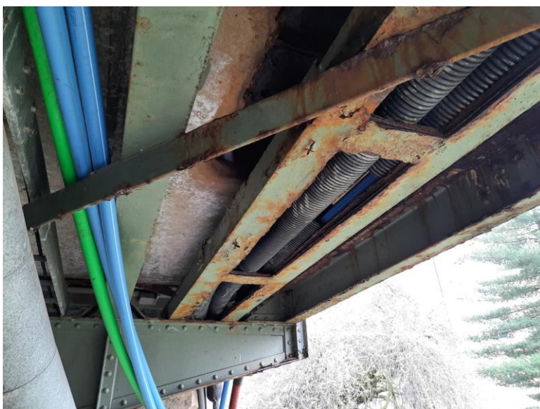
Koroze úložných prvků vedení inženýrských sítí.
