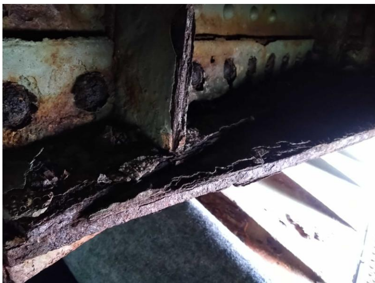
Koroze dolní pásnice příčnicku nad výtokovou stranou pravobřežního pilíře (blízko uložení na ložisko).
