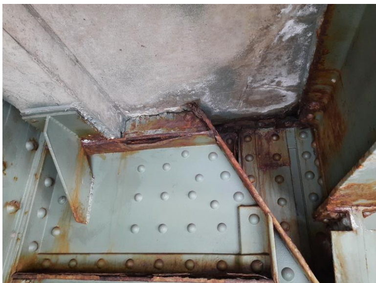
Koroze nepodporového ztužení nad vtokovým ložiskem pravobřežního pilíře, horní část pod deskou.
