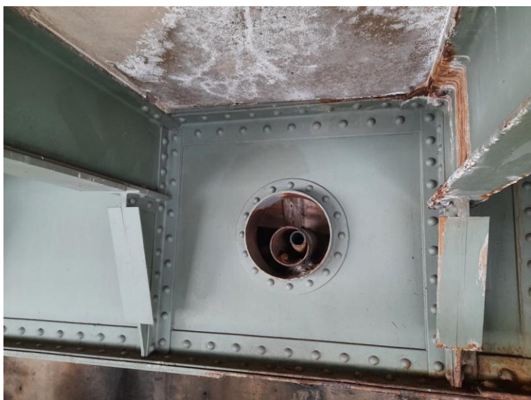
Průsaky a zatékání nad levobřežní opěrou.
