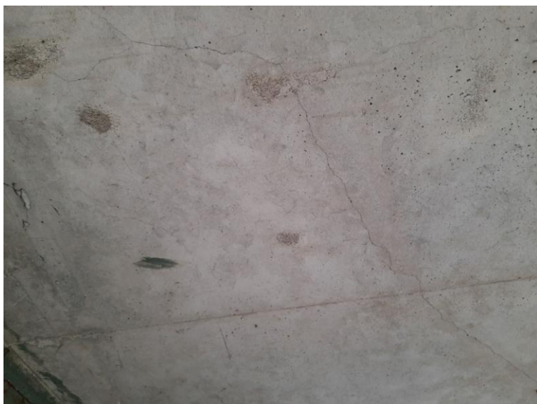
Trhliny na podhledu desky mostovky v pravobřežním poli blízko opěry.
