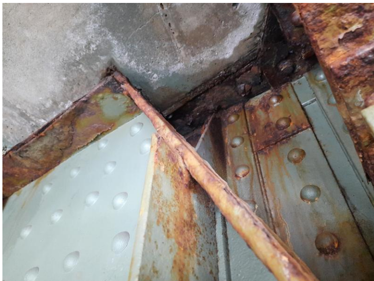
Koroze horní pásnice příčnicku a podélníků nad pravobřežním pilířem.
