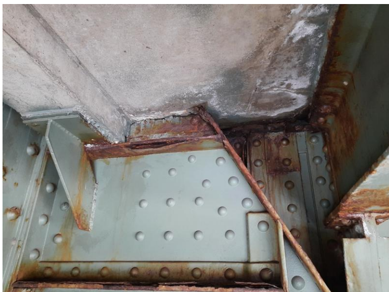
Koroze nepodporového ztužení nad vtokovým ložiskem pravobřežního pilíře, horní část pod deskou.
