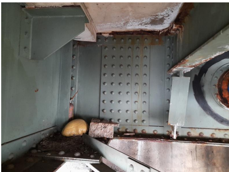
Zatékání na podhledu desky a koroze podélníků na vtoku nad levobřežní opěrou.
