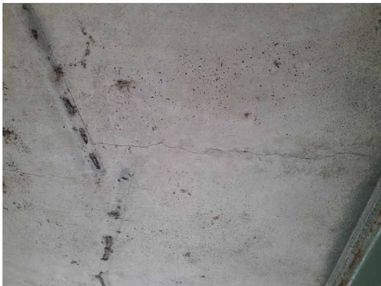
Trhliny na pohledu desky nad pravobřežním pilířem.
