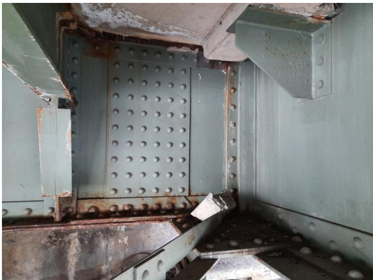
Koroze styčnicku dolní pásnice koncového příčnicku a hlavního nosníku nad výtokovým ložiskem levobřežní opěry.
