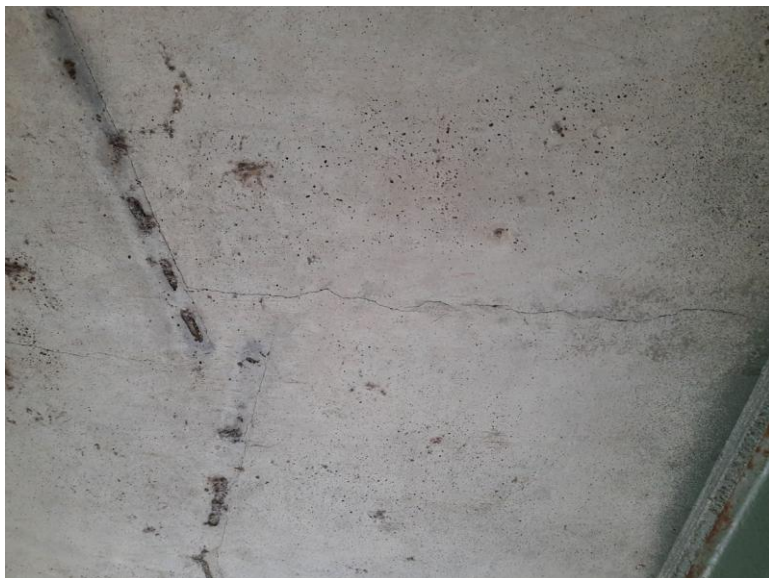
Trhliny na pohledu desky nad pravobřežním pilířem.
