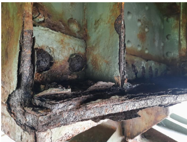
Detail koroze nad vtokovým ložiskem pravobřežního pilíře.
