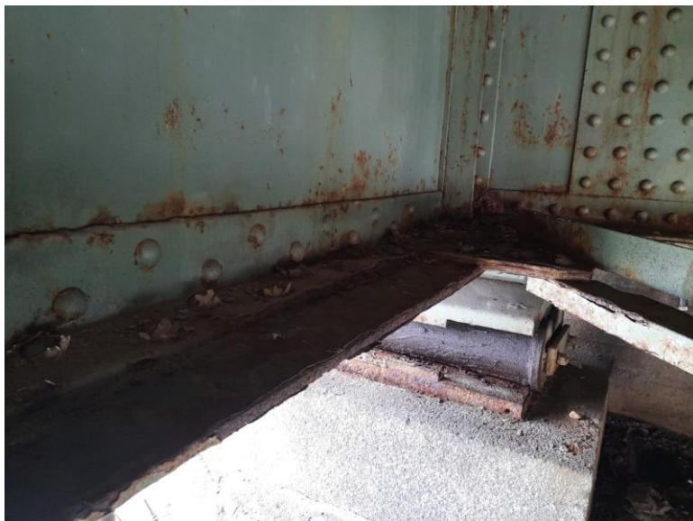
Koroze styčnicku nad výtakovým ložiskem pravobřežní opěry.
