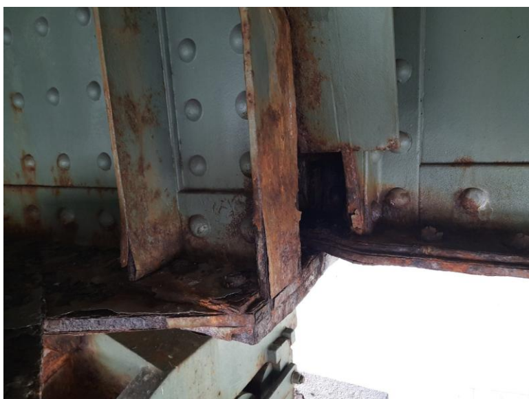
Koroze a deformace dolní pásnice příčnicku v místě styku s hlavním nosníkem na pravobřežním pilířem.
