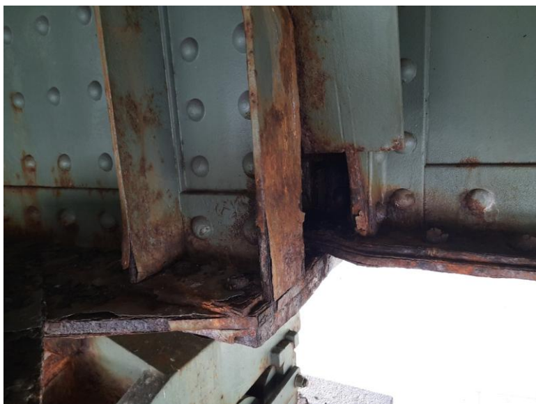
Koroze a deformace dolní pásnice příčnicku v místě styku s hlavním nosníkem na pravobřežním pilířem.
