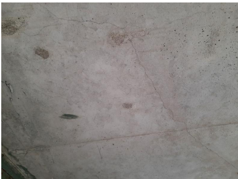
Trhliny na pohledu desky mostovky v pravobřežním poli blízko opěry.
