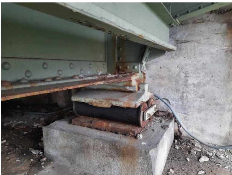
Výtokové ložisko na levobřežní opěře, koroze dolní pásnice hlavního nosníku.
