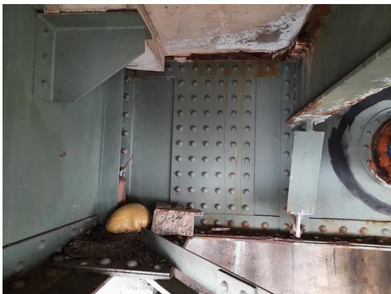
Zatékání na podhledu desky a koroze podélníků na vtoku nad levobřežní opěrou.
