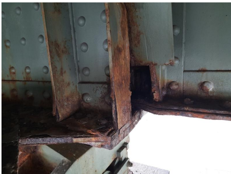
Koroze a deformace dolní pásnice příčnicku v místě styku s hlavním nosníkem na pravobřežním pilířem.
