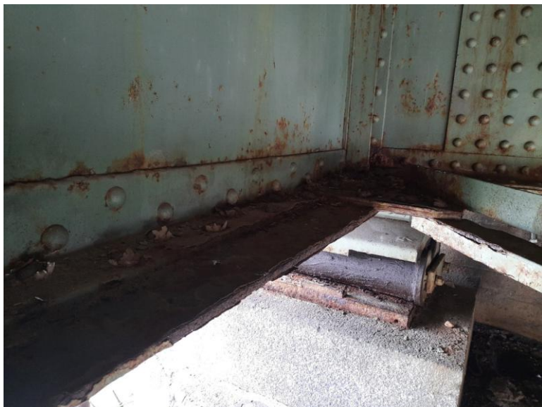
Koroze styčnicku nad výtokovým ložiskem pravobřežní opěry.
