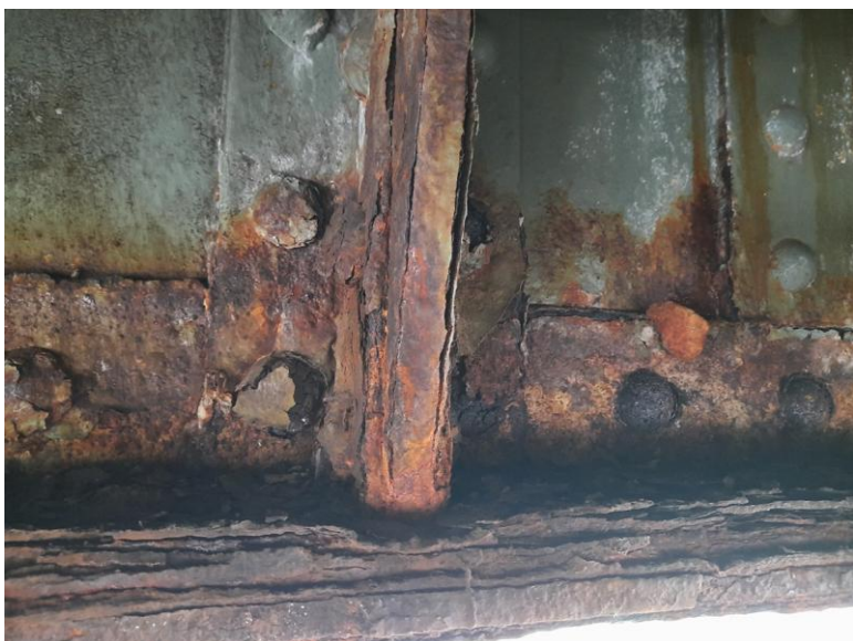
Detail koroze dolní pásnice příčnicku nad pravobřežním pilířem.
