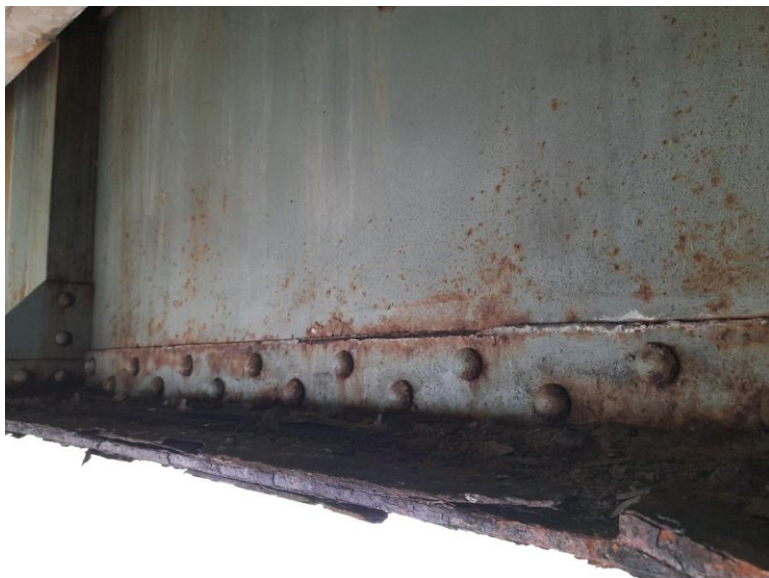
Koroze dolní pásnice hlavního nosníku nad pravobřežním pilířem.
