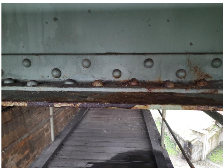
Koroze dolní pásnice hlavního nosníku na výtoku u pravobřežní opěry.
