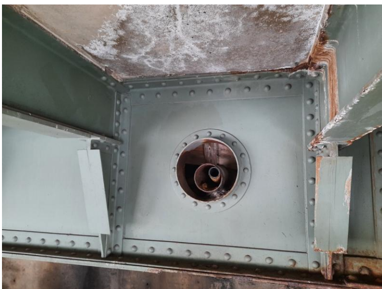
Průsaky a zatékání nad levobřežní opěrou.
