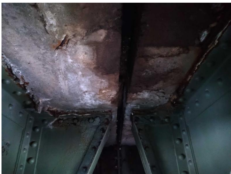
Zatékání dilatační spárou dosud nevybouranou nad pravobřežním pilířem na výtokové straně.
