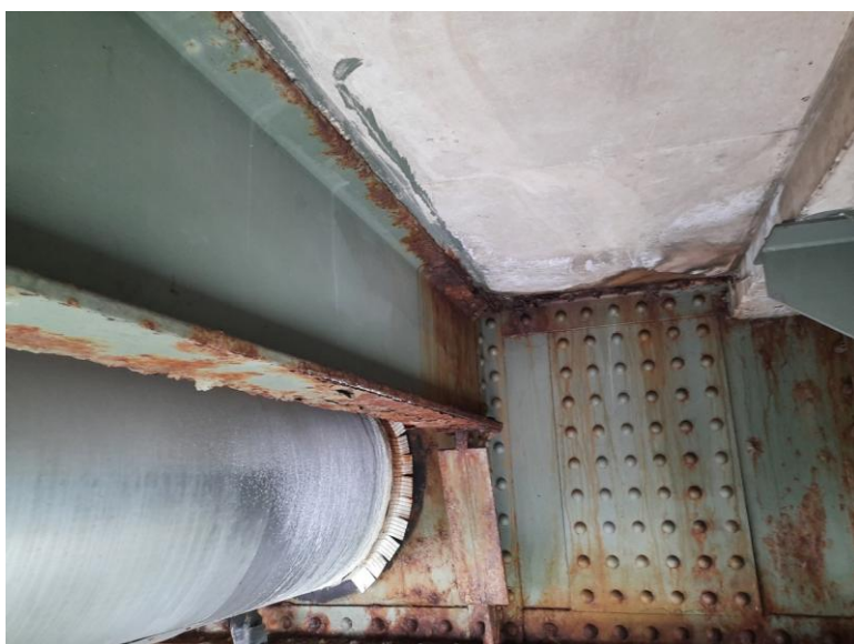
Koroze podélníků u koncového příčnicku nad pravobřežní opěrou.
