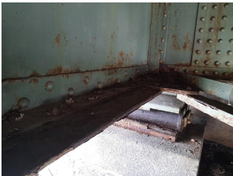
Koroze styčnicku nad výtokovým ložiskem pravobřežní opěry.
