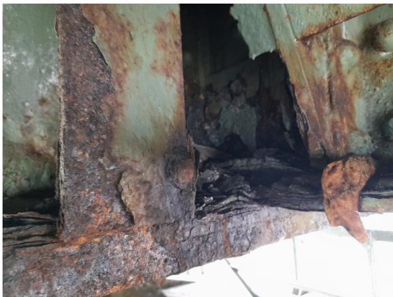
Styk příčnicku s hlavním nosníkem nad pravobřežním pilířem.
