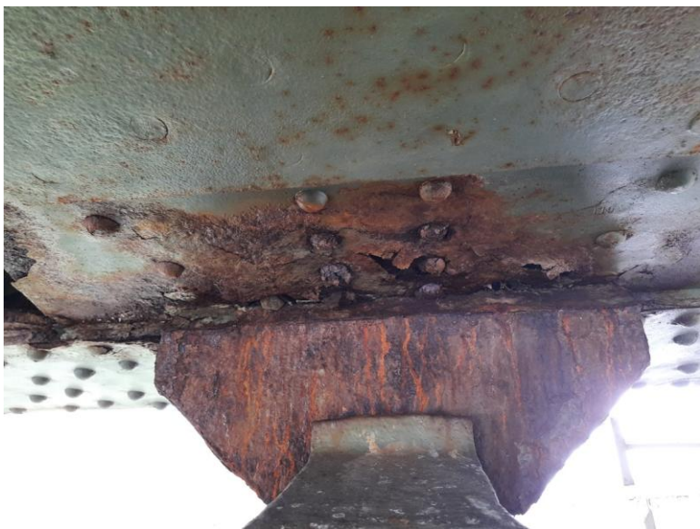
Koroze úložné desky nad vtokovým ložiskem pravobřežního pilíře.
