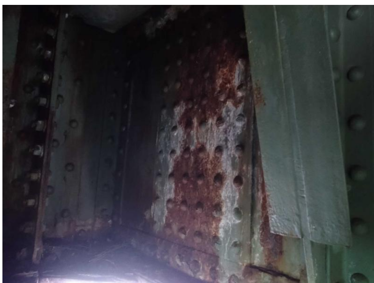
Koroze styku příčnicku s nosíkem nad výtokovým uložením pravobřežního pilíře.
