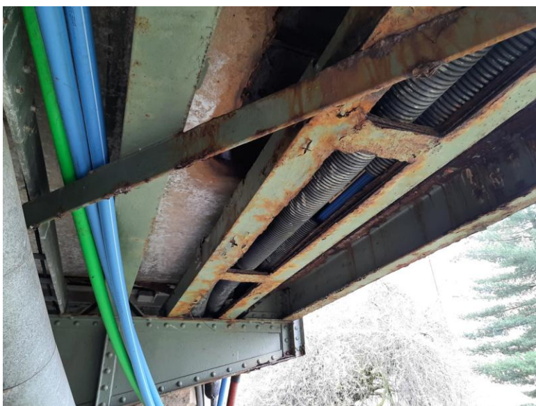
Koroze úložných prvků vedení inženýrských sítí.
