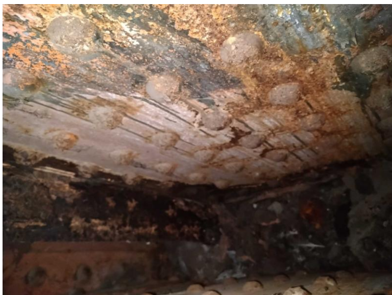
Koroze špatně přístupné dutiny nad vtokovým ložiskem pravobřežního pilíře.
