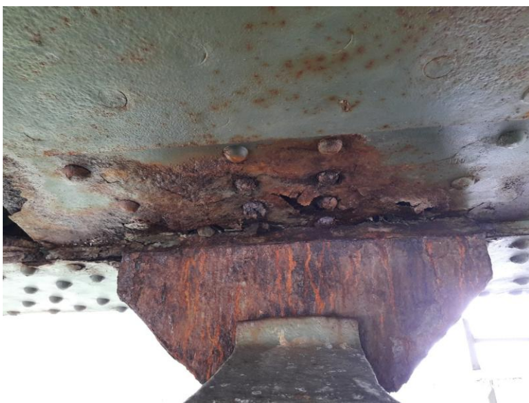
Koroze úložné desky nad vtokovým ložiskem pravobřežního pilíře.
