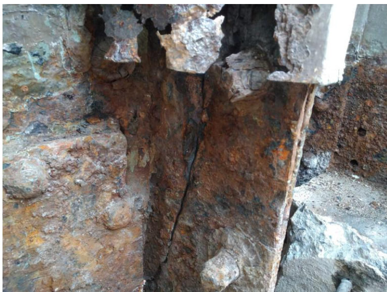
Trhlina ve stykovaní, konkrétně v čelní desce na vnitřní straně výtokového hlavního nosníku. Čelní deska je vytvořena ohýbaným plechem do L původně nýtovaným.
