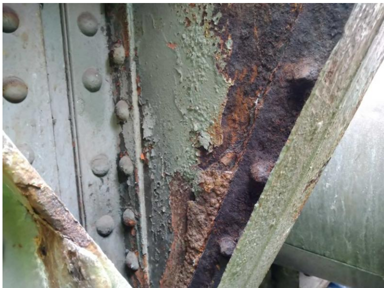
Koroze koncových konzolových výztuh mezi podporovým příčником a příčником pravobřežního pole (pod deskou s odbouranou dilatační spárou).
