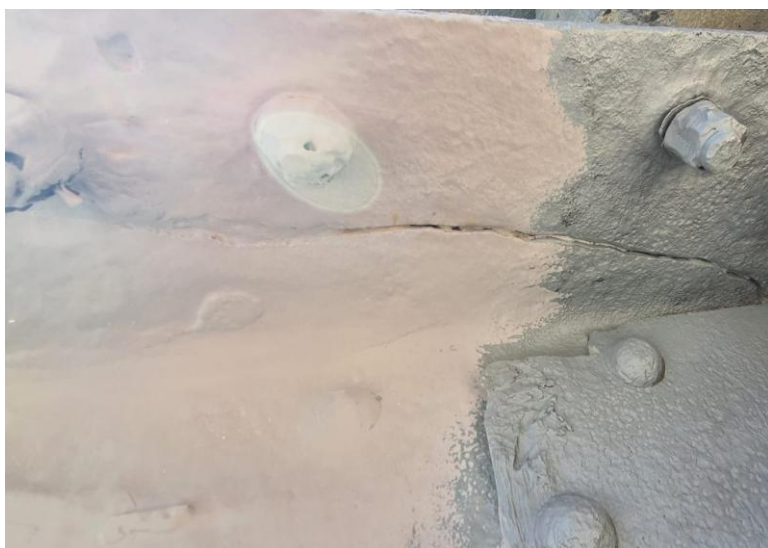
Trhlina očištěná pískováním od korozních produktů, podél stěny hlavního nosníku je patrné masivní oslabení přinýtovaného L plechu korozními úbytky.
