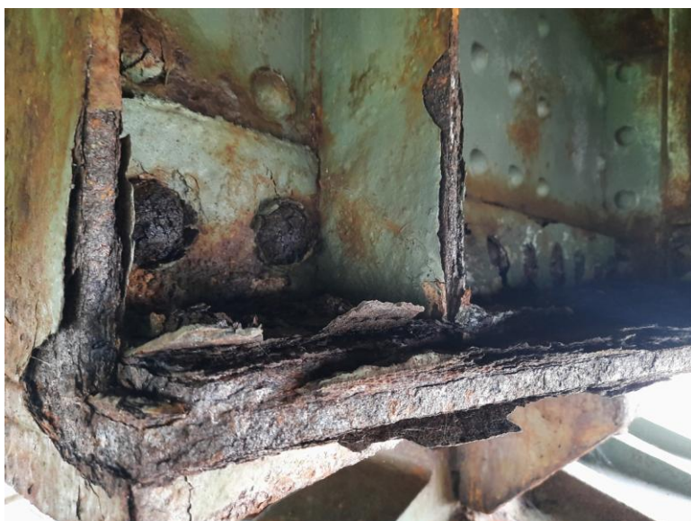
Detail koroze nad vtokovým ložiskem pravobřežního pilíře.
