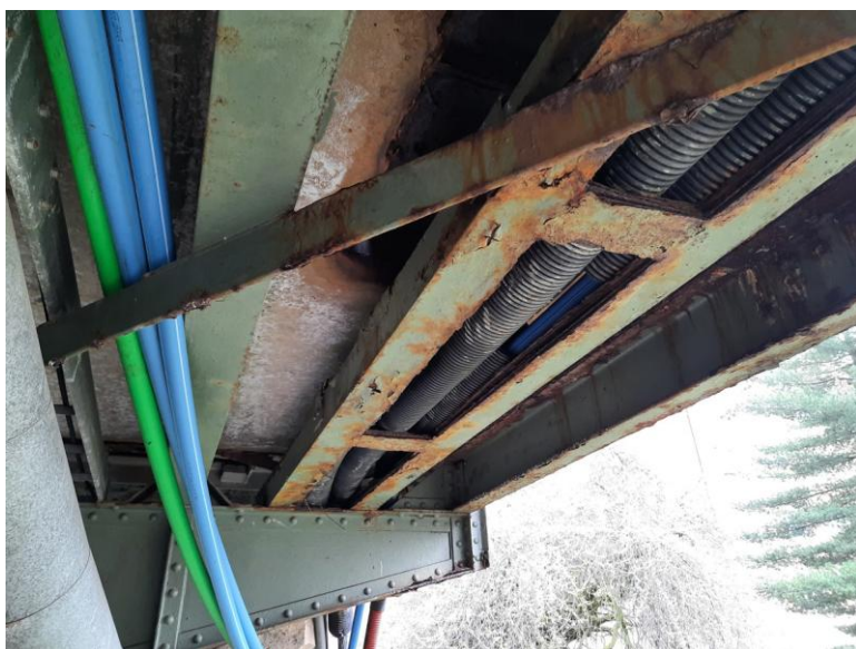
Koroze úložných prvků vedení inženýrských sítí.
