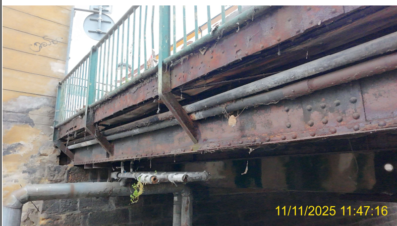
Koroze krajních římsových plechů a nosníků, ke kterým je přivařeno zábradlí. (z dronu)
