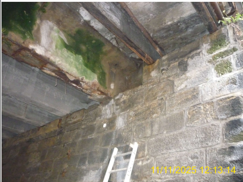
Celkový pohled na krajní betonový nosník na výtokové straně s odhalenou výztuží, degradací betonu a porostlý mechem
