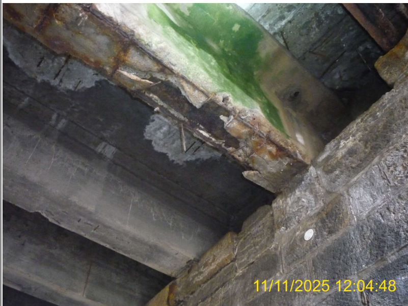
Koroze výztuže krajních nosníků v uložení na opěry
