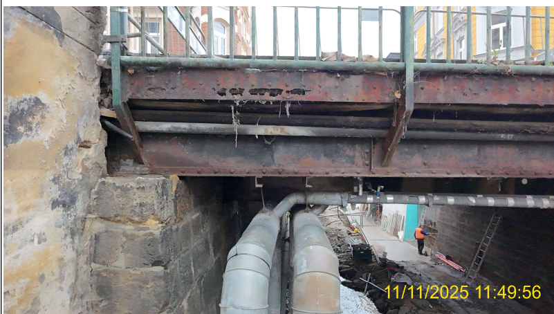
Koroze krajních ocel. nosníků chodníkových konzol z prokorodováním chodníkových plechů (z dronu)
