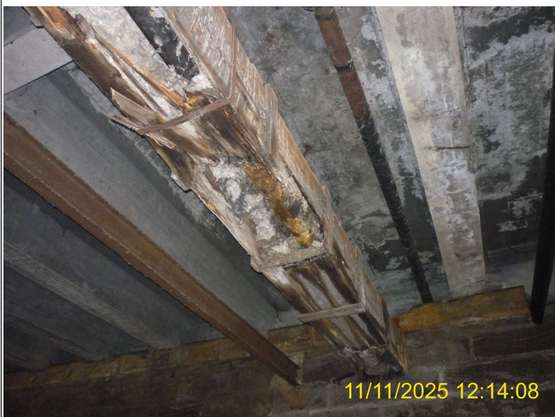
Koroze a degradace chrániček a dřevěného žlabu pod mostem.
