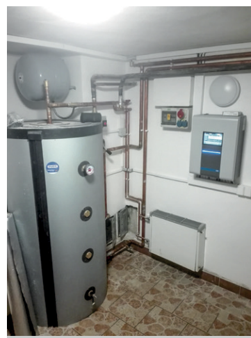
Stejná kotelná po přestavbě na tepelné čerpadlo
